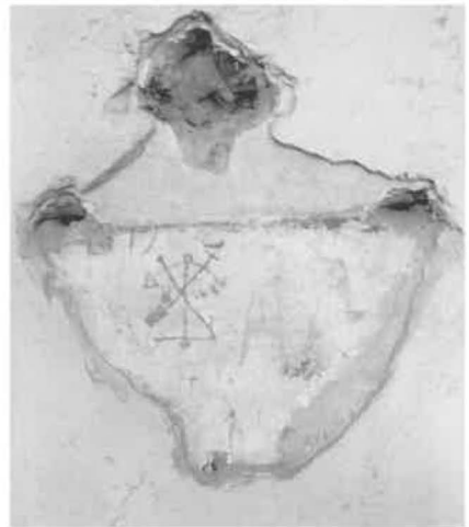
Graffiti auf der Putzschicht aus der Barockzeit
